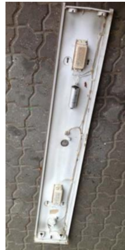
Kondensatorer i armaturer
